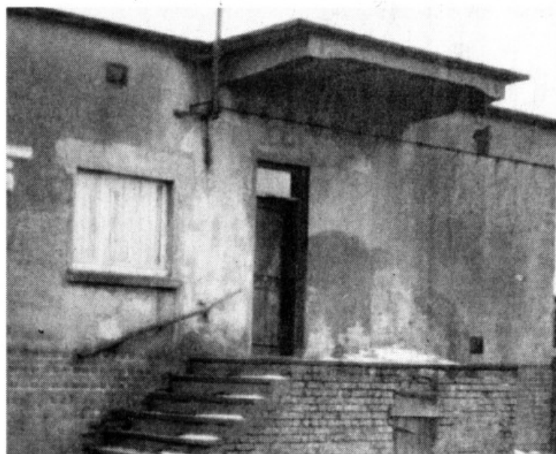
Einer der im Jahr 1918 gebauten 168 Schuppen vom Typ A im Block D auf einem Foto aus dem Jahr 1959.
