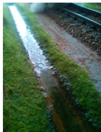
Der Graben direkt am Gleis führt das Regenwasser ab
